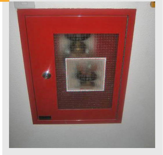
Imagen N° 45: Gabinetes de Red Húmeda empotrados a plomo de muro.
