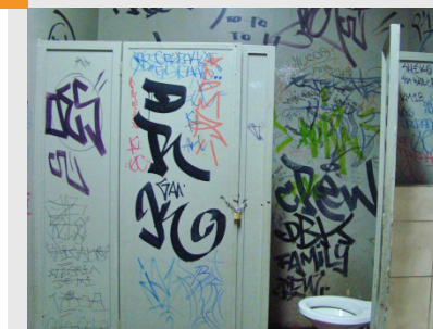
Imagen N° 7: Baños con falta de control visual, permiten acciones indebidas que incrementan la percepción de deterioro e inseguridad en los recintos.
